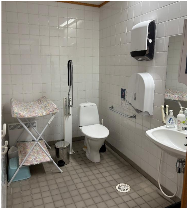
Esteetön wc ja lastenhoituhuone.
