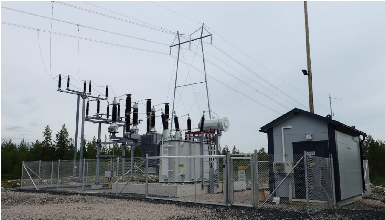
Kuva 5-8. Esimerkki tuulivoimapuiston sähköasemasta (Kuva: Minna Takalo/FCG).
