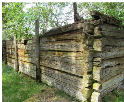
Kuva 5. Lahonneen hirsirakennuksen ulkoseinä, johon kiinnitettiin ikkunapyydys TWT-05
