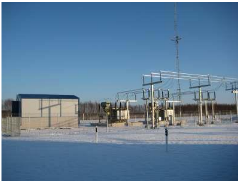
Kuva 3-11. Sähköasema (Kuva: Eltel Networks Oy).
