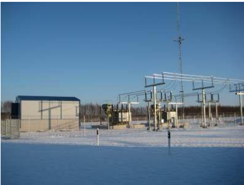
Kuva 15. Sähköasema (Kuva: Eltel Networks Oy)
