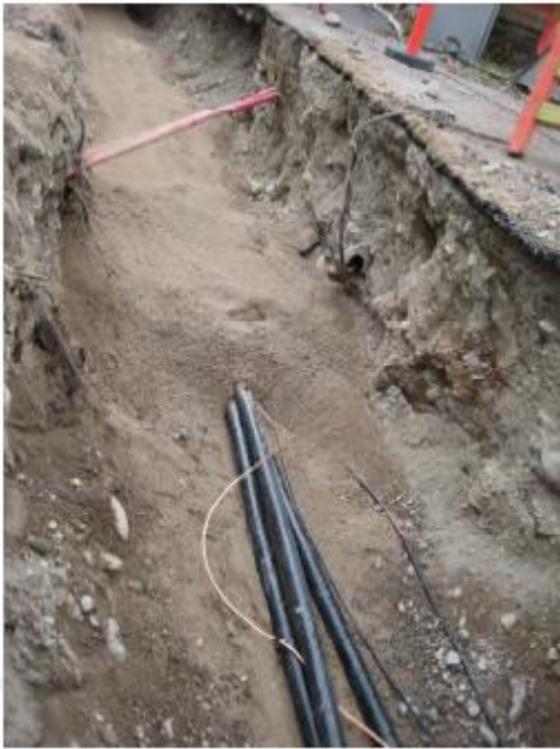
Kuva 14. Puiston sisäisessä sähkönsiirrossa käytetään pääasiassa yhdysteiden viereen asennettavia maakaapeleita (Kuva: www.reka.fi() )
