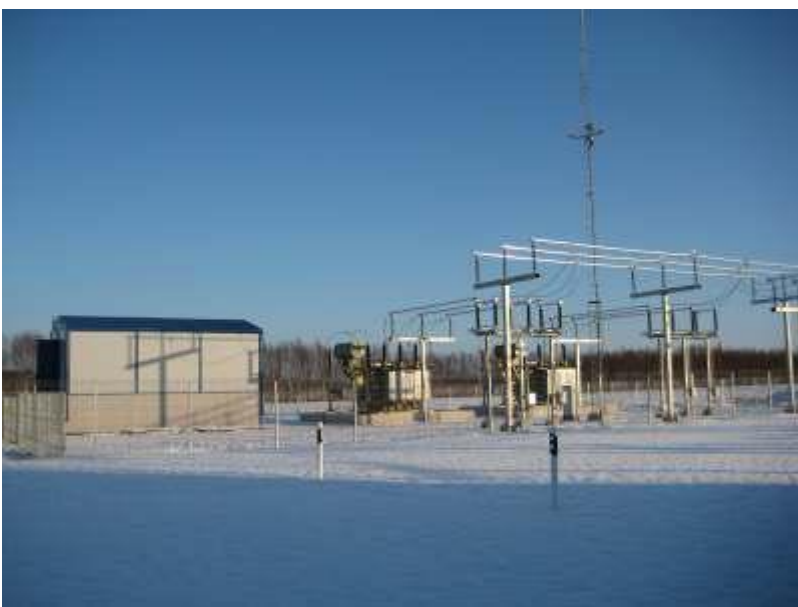
Kuva 16. Sähköasema (Kuva: Eltel Networks Oy)
