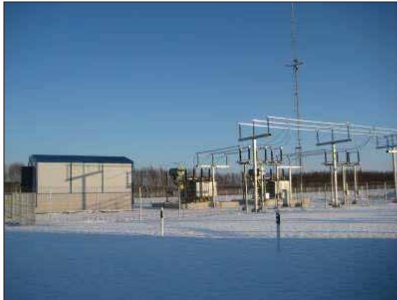
Kuva 3-12. Sähköasema (Kuva: Eltel Networks Oy).
