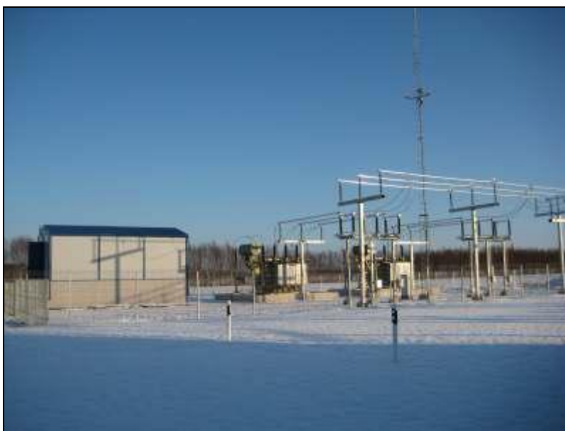
Kuva 3-11. Sähköasema (Kuva: Eltel Networks Oy).
