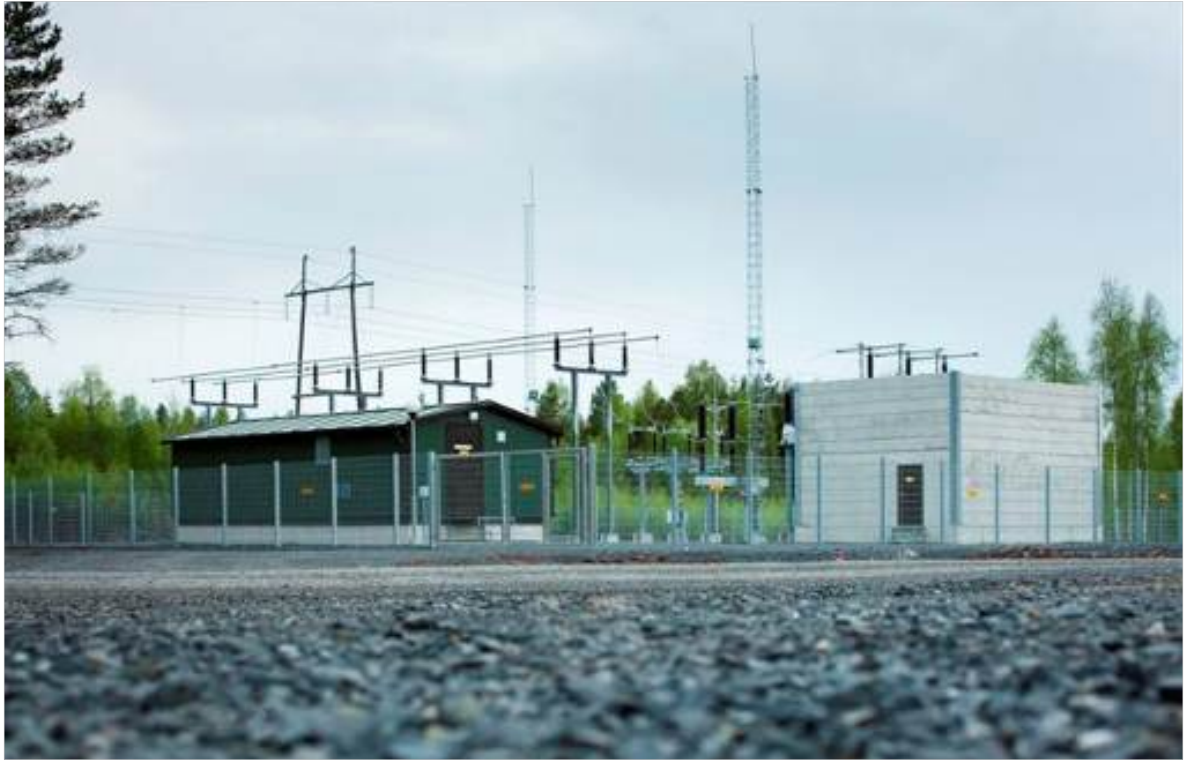
Kuva 17. Näkyvimät komponentit sähköasemalla ovat suojarakennus, kytkinkenttä, ukkosmastot sekä muuntajabunkkeri (kuva VEO OY).
