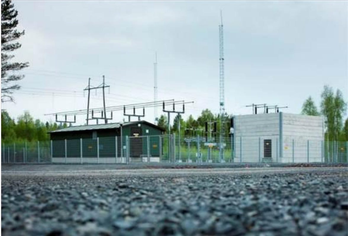
Kuva 21. Näkyvimät komponentit sähköasemalla ovat suojarakennus, kytkinkenttä, ukkosmastot sekä muuntajabunkkeri (kuva VEO OY).
