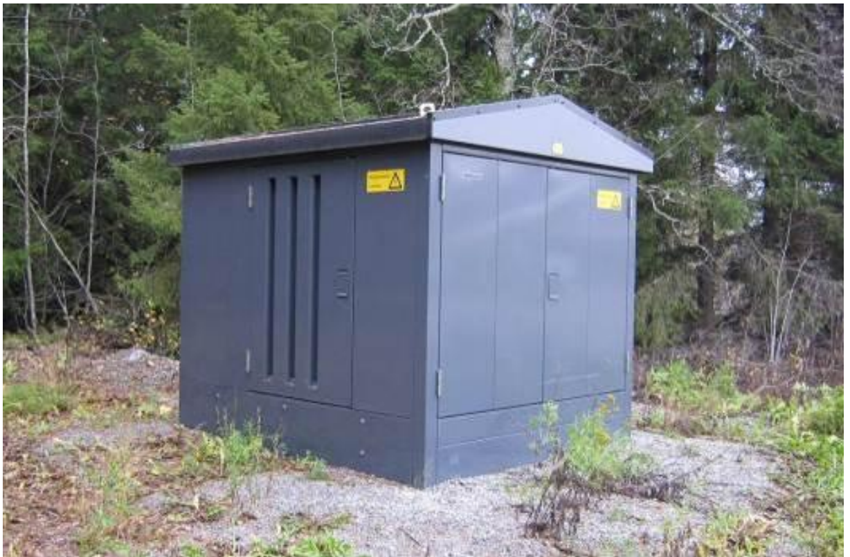
Kuva 20. Puistomuuntamot toimivat keskijännitekaapeleiden yhdistymispisteinä ja 1/20kV muuntajien suojarakennuksina (kuva: Janne Märsylä/ FCG).
