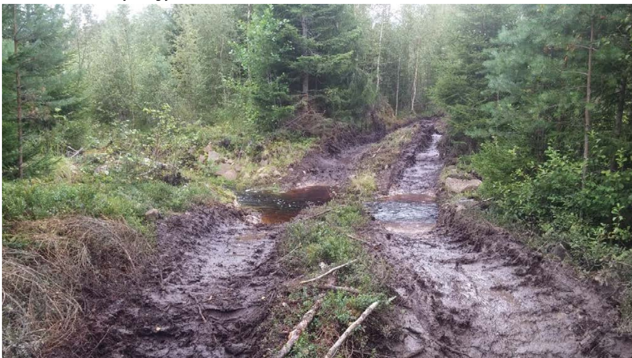
Bild 8. En mycket dåligt utförd överfart.
